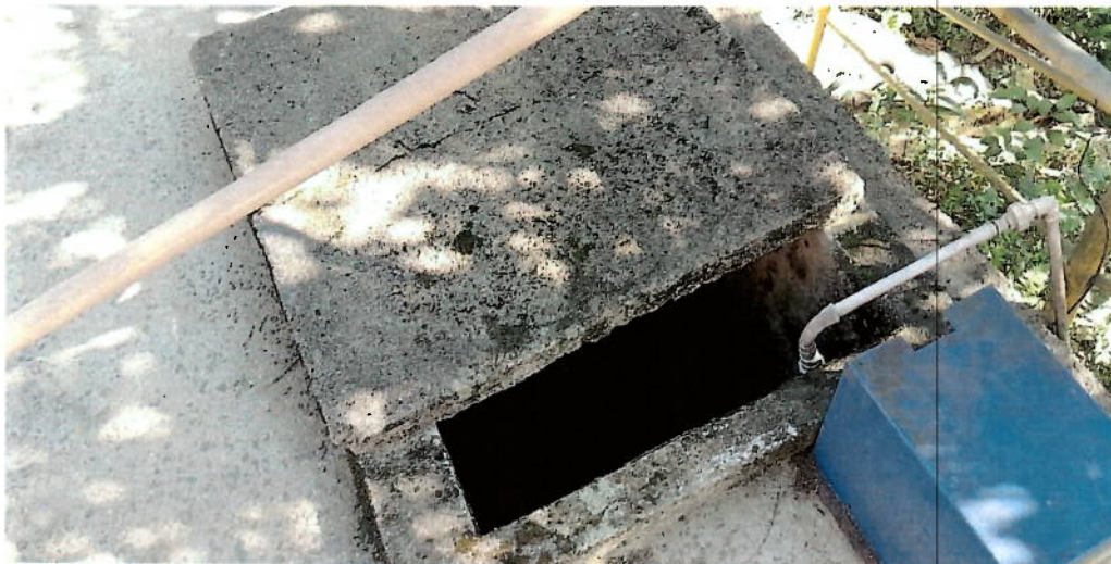
Foto 15 - - Tampa de inspeção do Reservatório (não oferece estanqueidade para proteção da água clorada).
