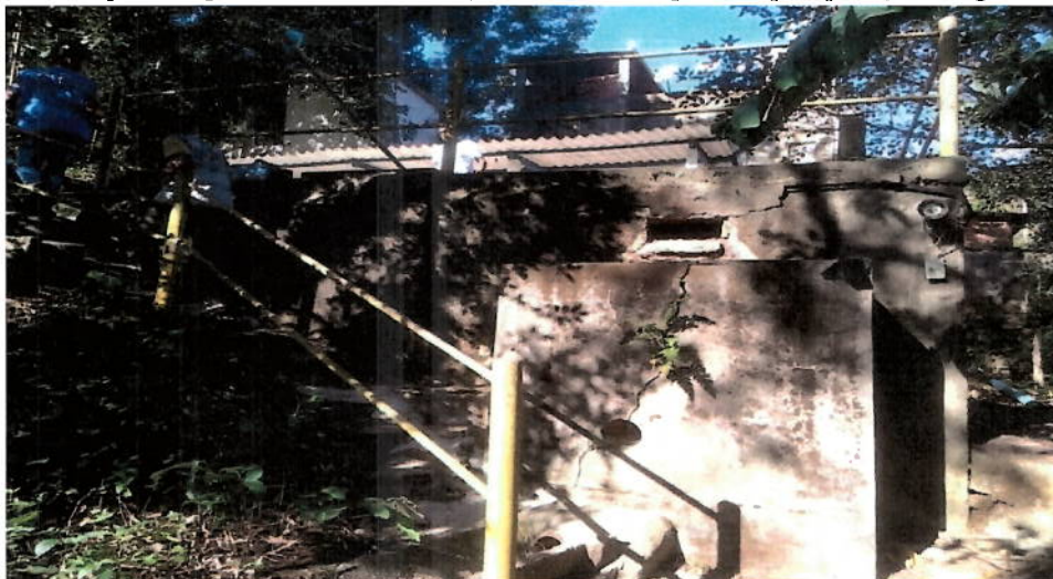
Foto 18 - Má conservação na estrutura do Reservatório.
