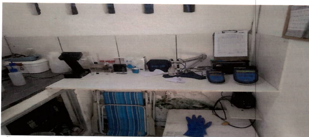
Foto 12 – Bancada do Laboratório da Unidade de Tratamento de Muriqui. Falta organização e Retirada de matérias inadequado aos serviços laboratoriais.
