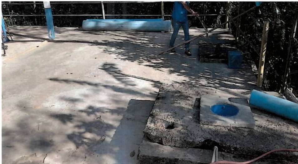
Foto 17 - Tampa de inspeção do Reservatório (não oferece estanqueidade para proteção da água clorada).
