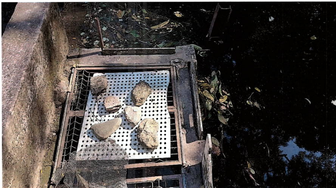
Foto 22 – Gradeamento preliminar, necessitando de reforma corretiva e preventiva.
