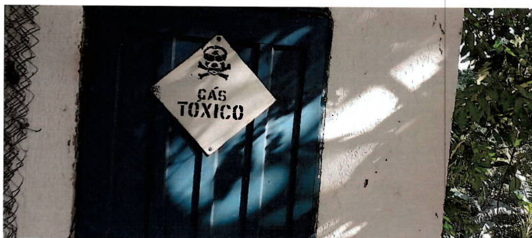
Foto 06 – Placa de identificação divergente do conteúdo de estoque, ausência de sinalização adequada de riscos específicos.
