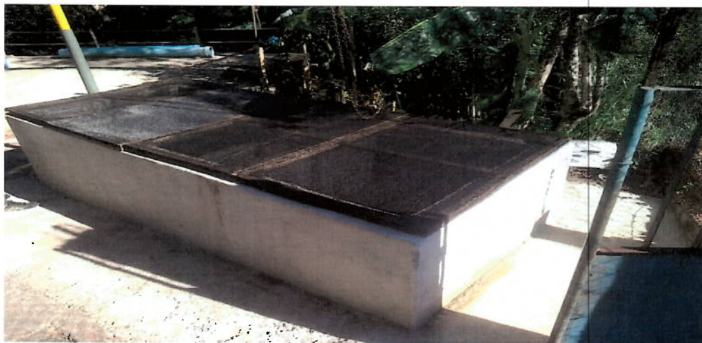
Foto 04 – Canal de gradeamento da Unidade.
