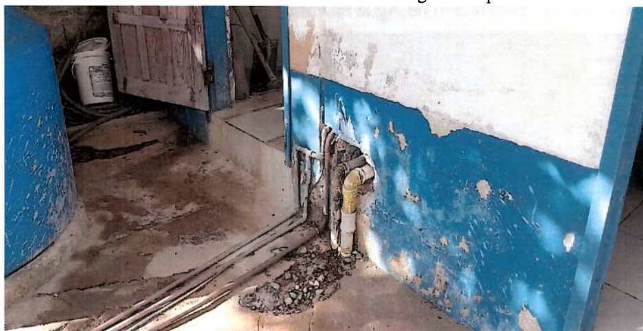
Foto 03 – Má conservação na estrutura da Unidade.
