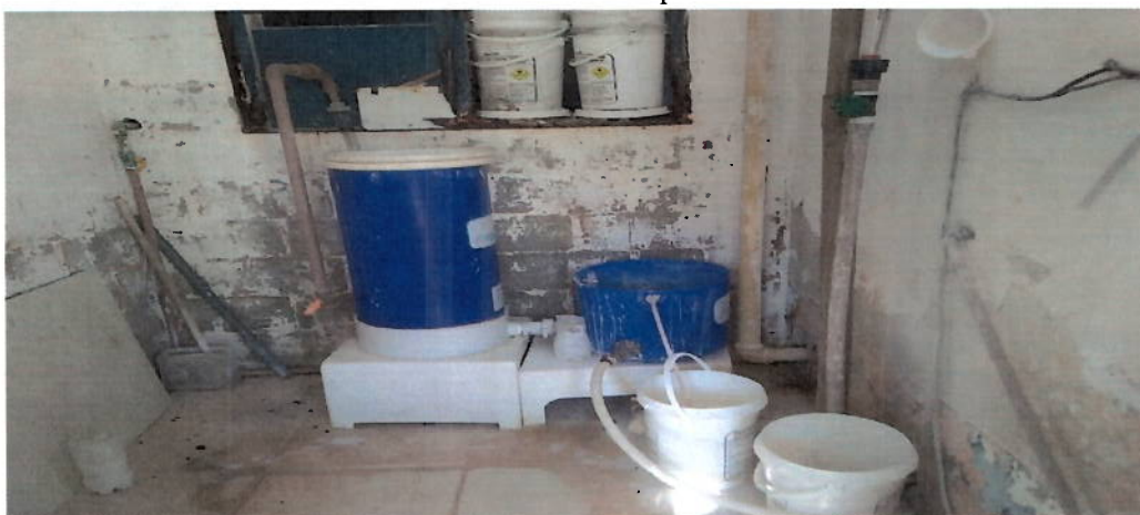
Foto 08 - Sistema de cloração com Hipoclorito de Cálcio. Local apresenta falta de manutenção.
