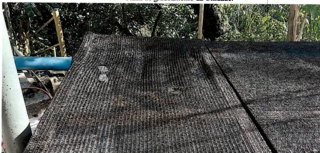
Foto 05 – Sinais de má conservação na tela de contenção.
